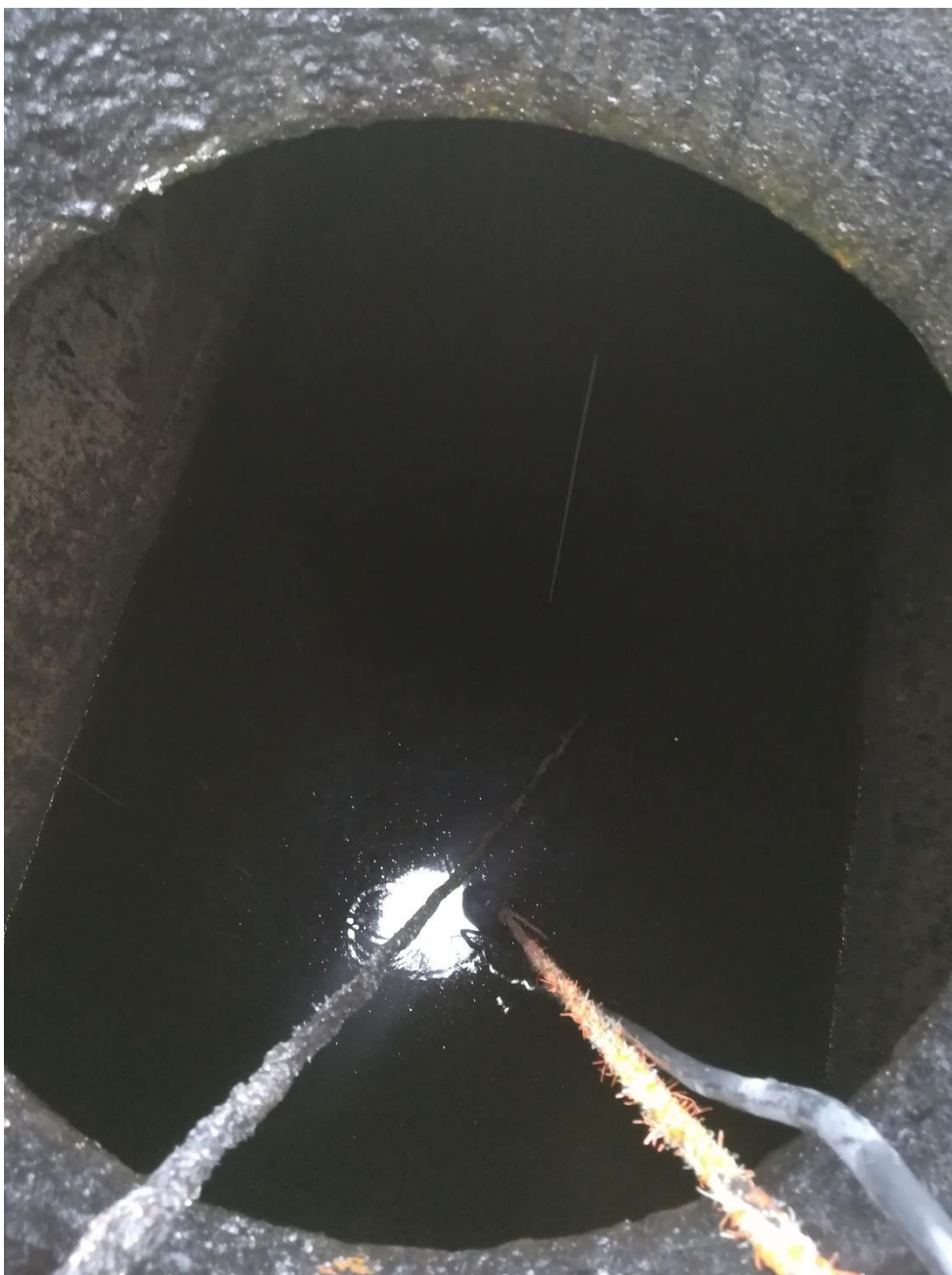
Billede 3 Der står vand i perkolattanken. Vandet pumpes op fra deponiet til tanken, hvorfra det føres renseanlæg.
