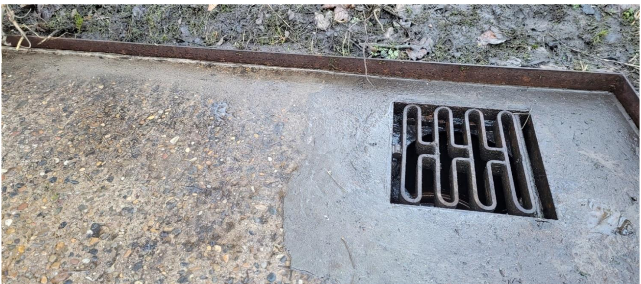
Afløbsrist på befæstet påfyldningsplads.
