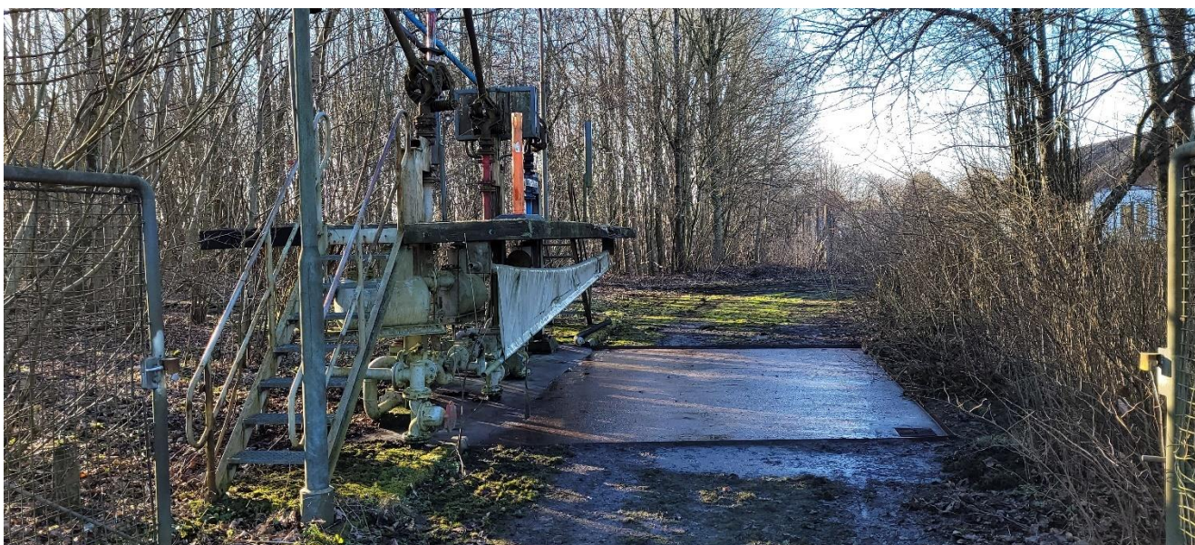
Befæstet påfyldningsplads med opkant og afløb til regnvands-/sikkerhedstank.
