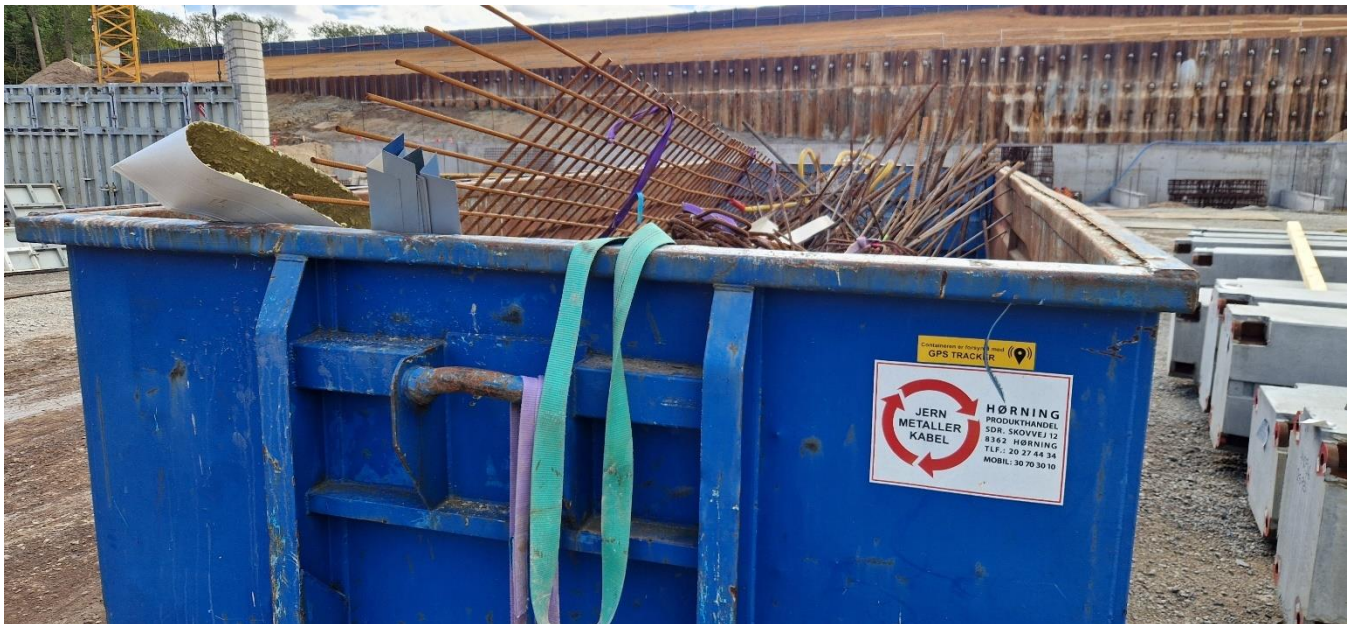
Container til metalaffald.
