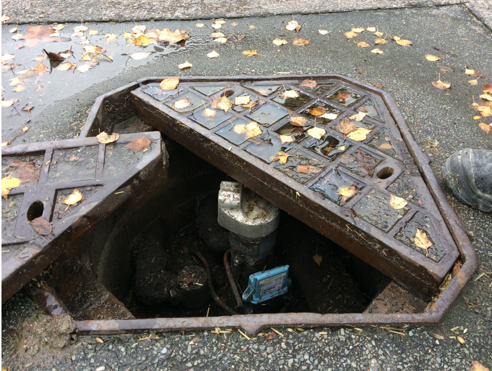
Billede 5 - Nedgravet diesel tank på 20.000 liter
