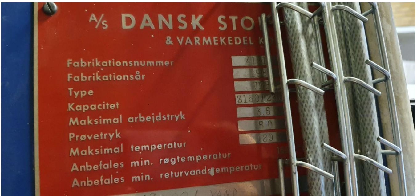
Mærkeplade på kedel 3 - 3150 Mcal/h = 3,66 MW fra 1968. Ikke i drift
