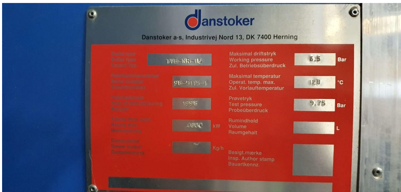
Mærkeplade på kedel 1 - 4,0 MW fra 1998
