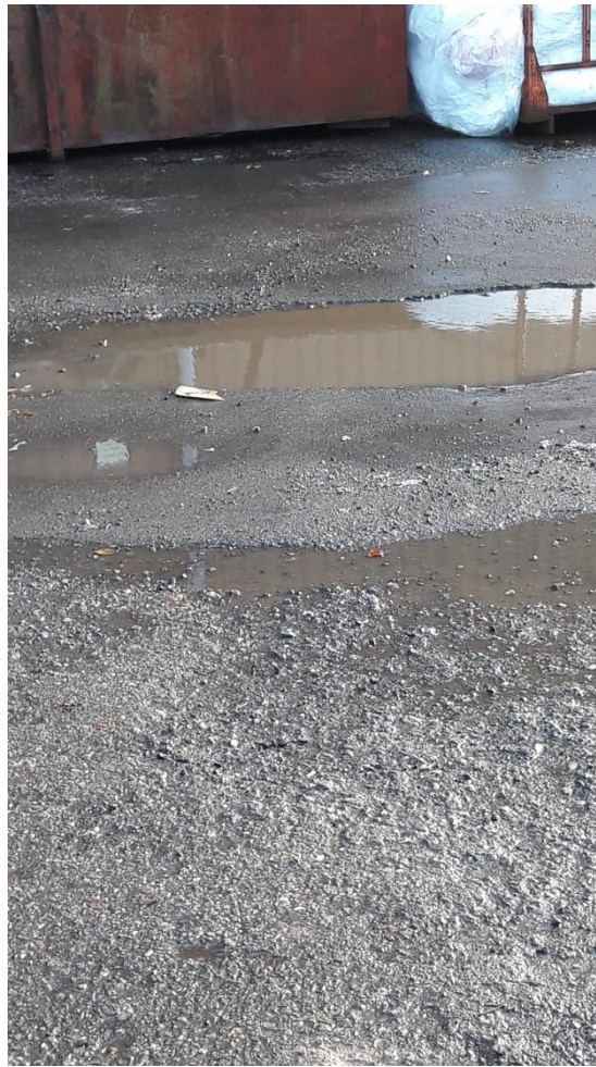
Belægninger er generelt pænt vedligeholdt, men enkelte steder er der huller.
