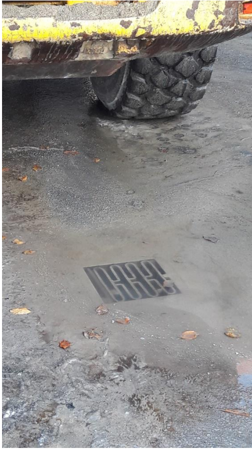
Afløbsbrønd foran oplag var tilstoppet
