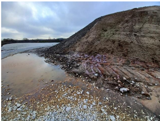
Foto 14: Udsivning fra dige.
