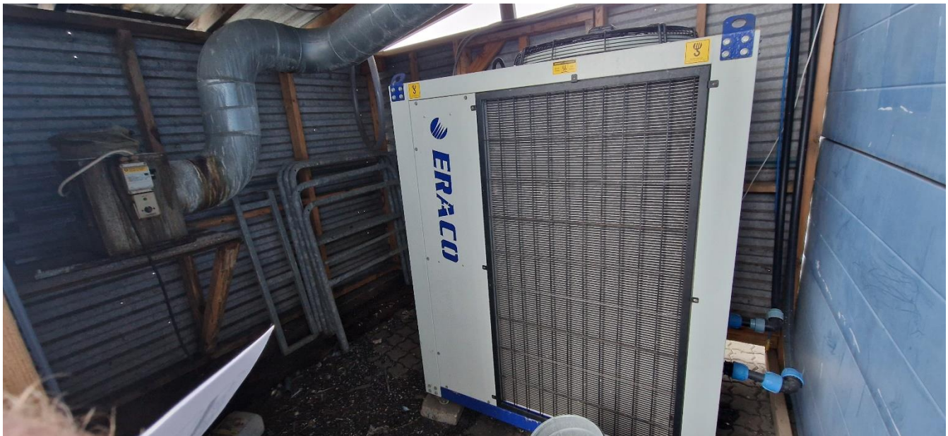
Skur med køleanlæg, hvor sugemotor til udsugning fra reaktoranlæg ligeledes står. Afkastet fra udsugning ender i skuret.
