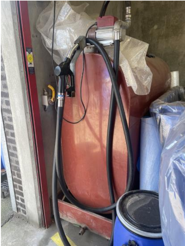
Billede 5. Opbevaring af dieselolietank.
