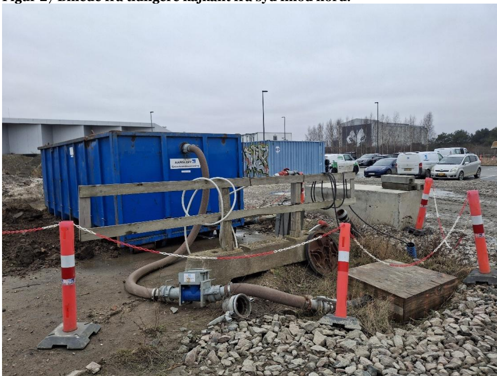
Figur 28 Container på tidligere kaj mod syd, til sedimentering og viderepumpning af perkolat/overfladevand til renseanlæg. Der er flowmåler i ledningerne.
