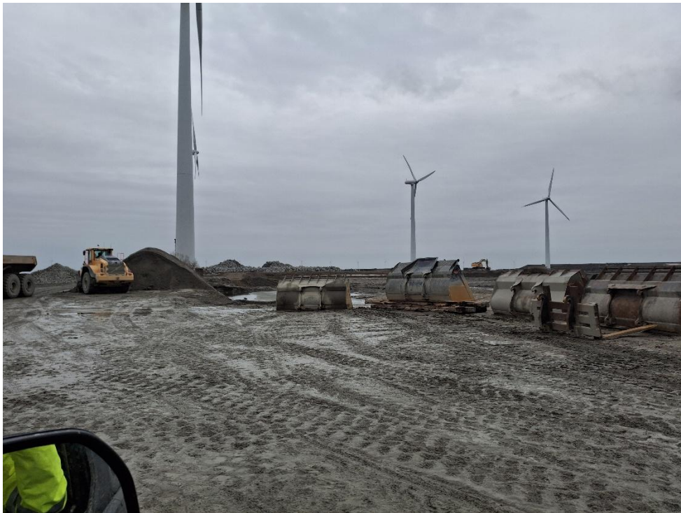
Figur 7. Udsigt fra kajen imod deponiets østlige side/dæmning her er slutaf-dækning begyndt og der holdte gravemaskine ude på deponiet.
