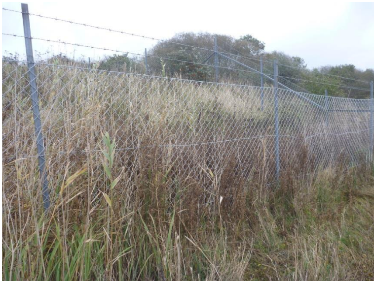
Billede af hegnet. Der blev ved tilsynet ikke konstateret huller eller lignende.
