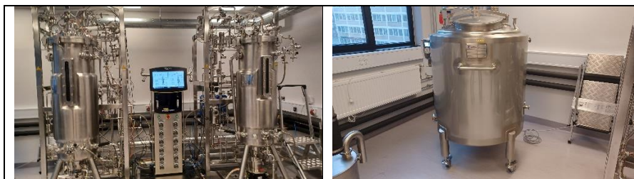
Gæringstank og 1. tank
