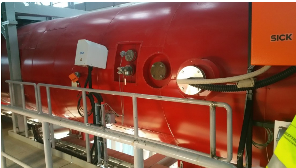
Måleudstyr i røggaskanal på BKVV
