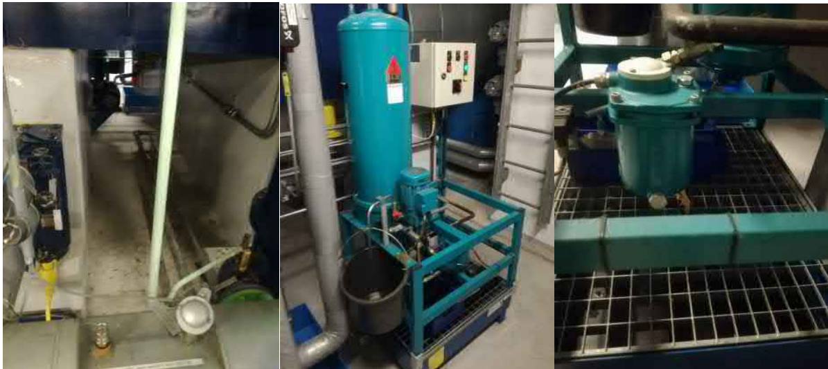
Figur 11: Tank med smøreolie til dampturbinen, samt oliefilter til tanken.
