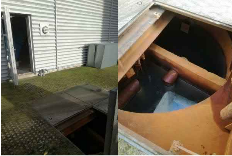
Figur 16: Olieudskillere ligger lige uden for bygningen.
