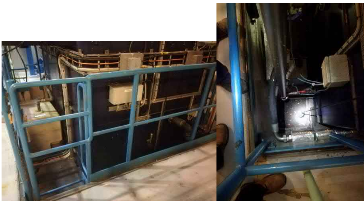
Figur 5: Smøreolietank til gasturbinen med alarm for eventuel tilstedeværelse af olie.
