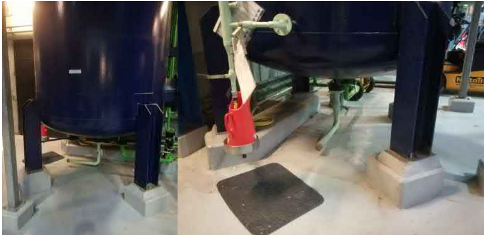
Figur 2: Glykoltank med to udledningsrør.
