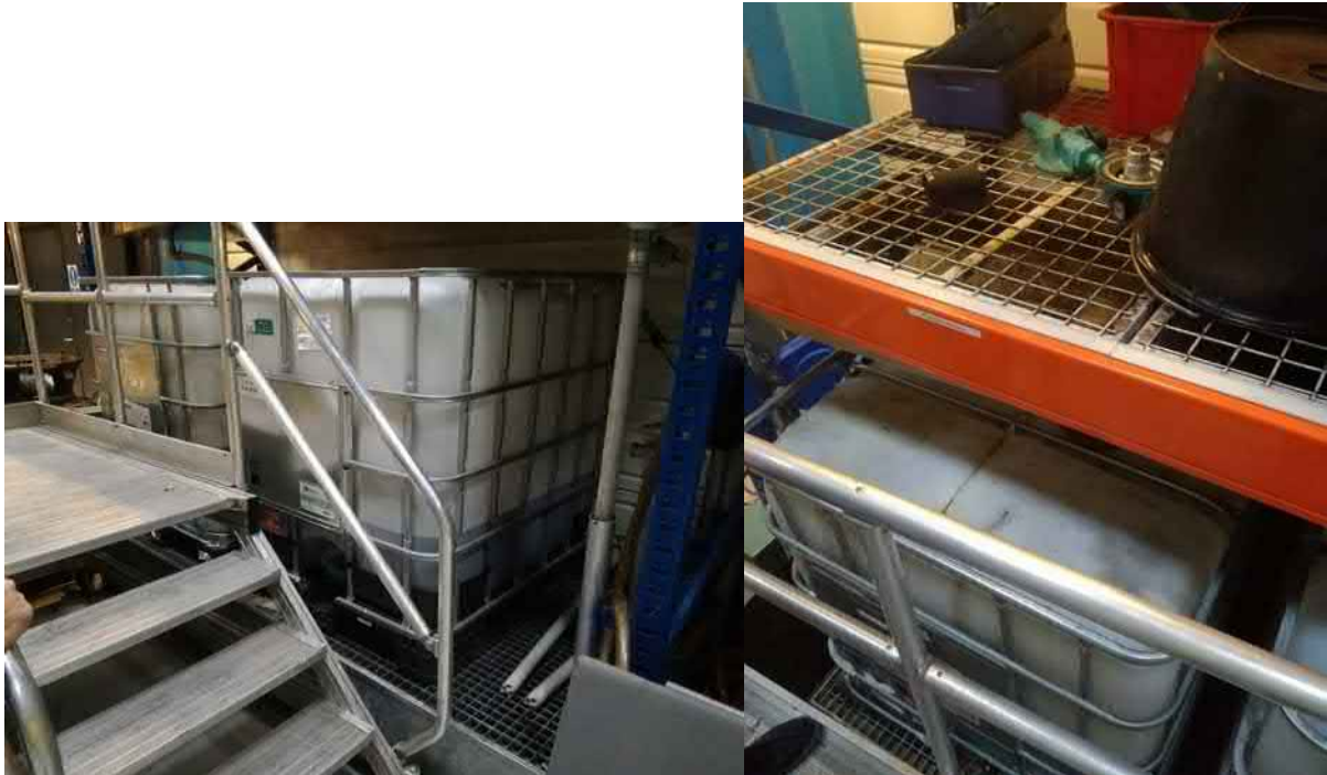
Figur 14: Oletank til brugt olie og opsamlingskar, hvor olie udtømmes fra små beholdere.
