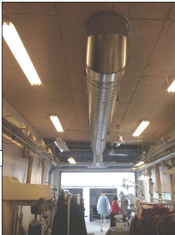
Ventilationsrør i finish-afdelingen
