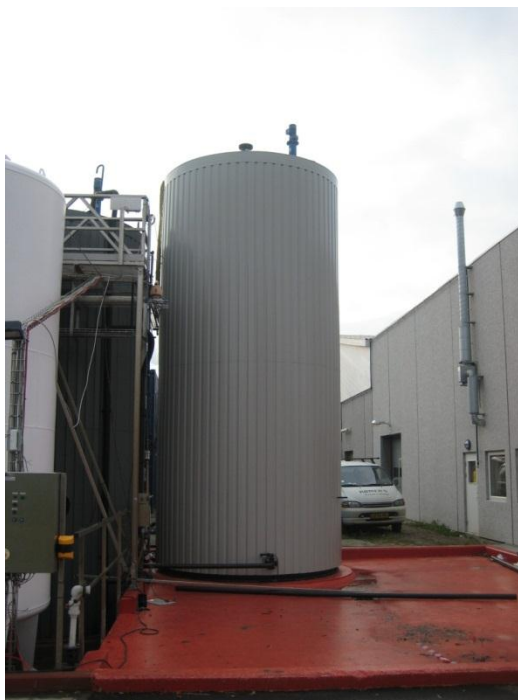
Billede 1. Spildbakke med plads til en tank til anilin/vand <1% anilin
