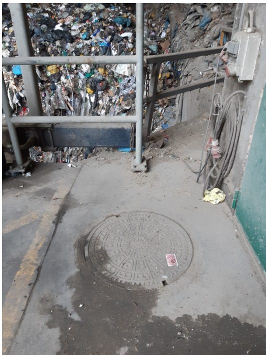
Prøver af drænvand tages fra denne brønd ved modtagesiloen
