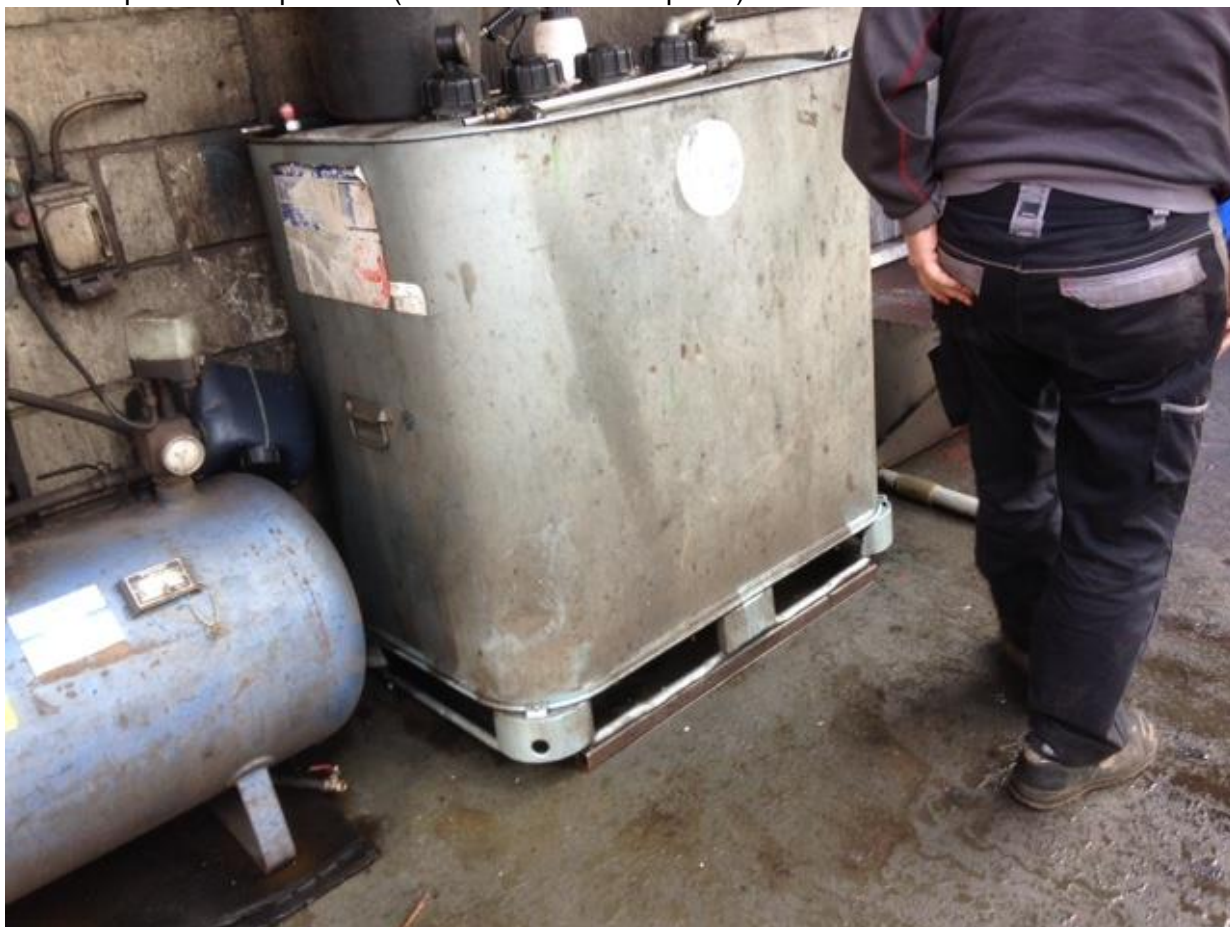
Foto 1: Spildolietank på 700 l (udendørs ved vaskeplads)
