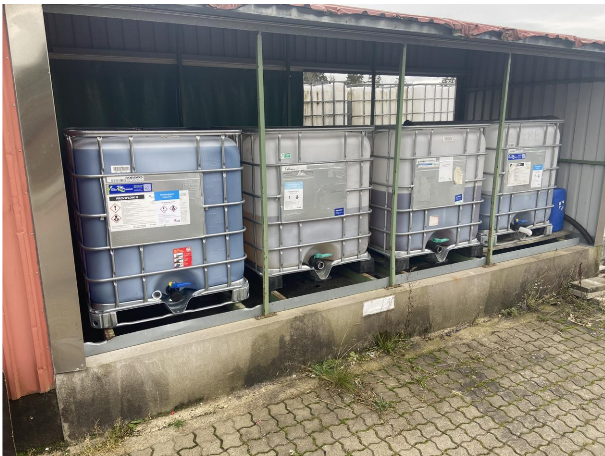
Opbevaring af glykol i palletanke over tæt grav.
