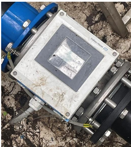
Foto 9: Da der ikke pumpes i perkolatpumpebrønden viser flowmåleren i måler brønden, at der ikke ledes perkolat bort fra deponiet lige nu (måler står på 0.00 m 3 /t).
