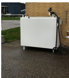
Tank uden påkørselssikring
