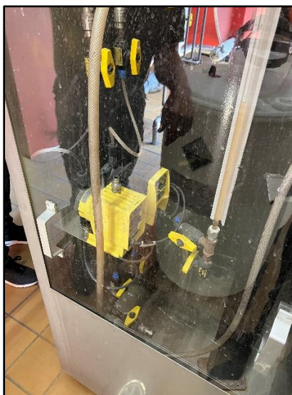
Lud i doseringsanlæg med opsamling
