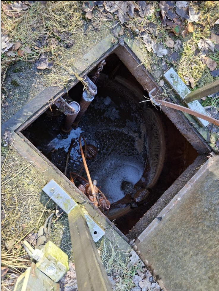
Foto 8: Pumpebrønd, hvorfra perkolat pumpes videre til Gram Renseanlæg.
