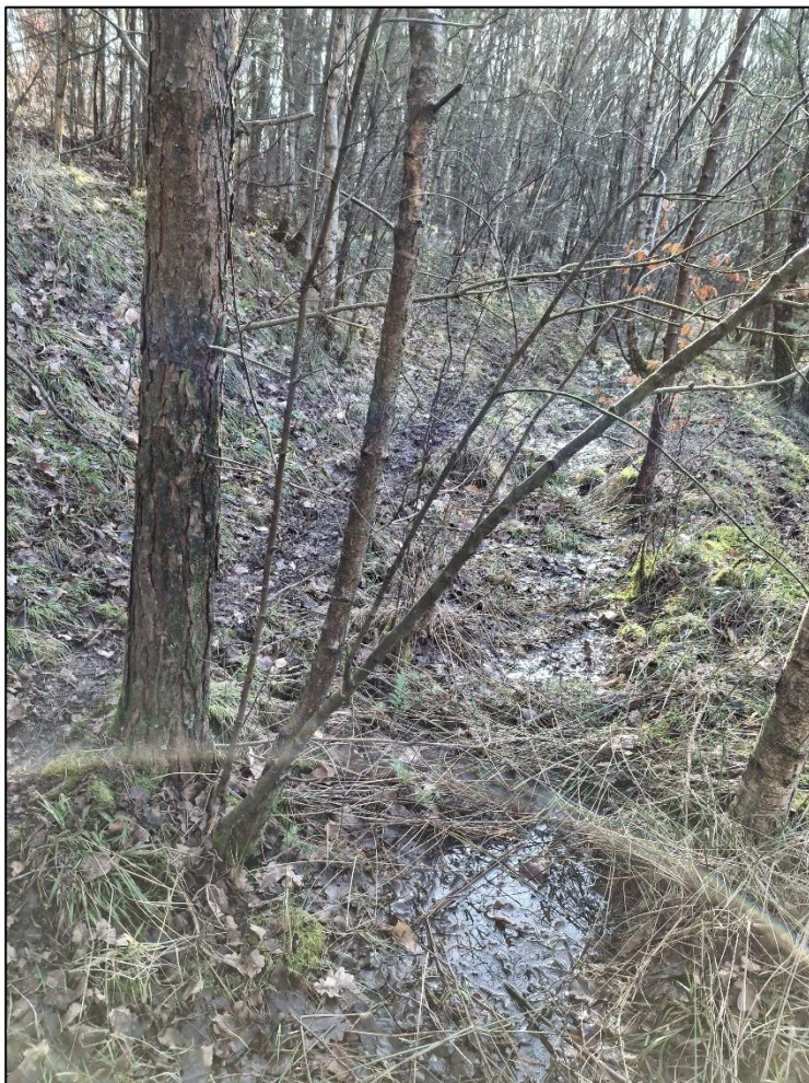
Foto 9: Tegn på overfladevand i formodet tidligere afskærende grøft langs den vestlige skråning mellem Etape 2 og lergrav 3.
