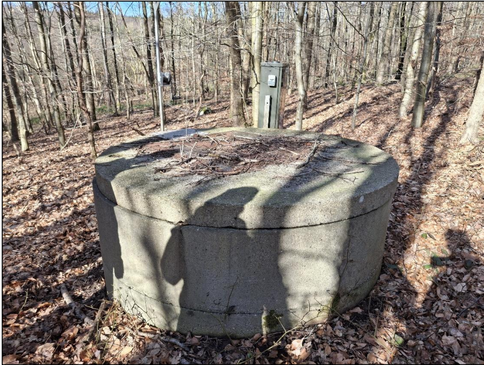
Foto 4: Perkolatbrønd 2, som modtager perkolat fra Etape 2. Brønden er etableret på Etape 2.
