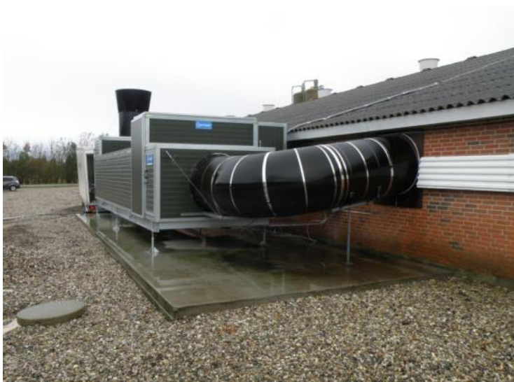
Varmeveksler opsat ved kyllingestald.
