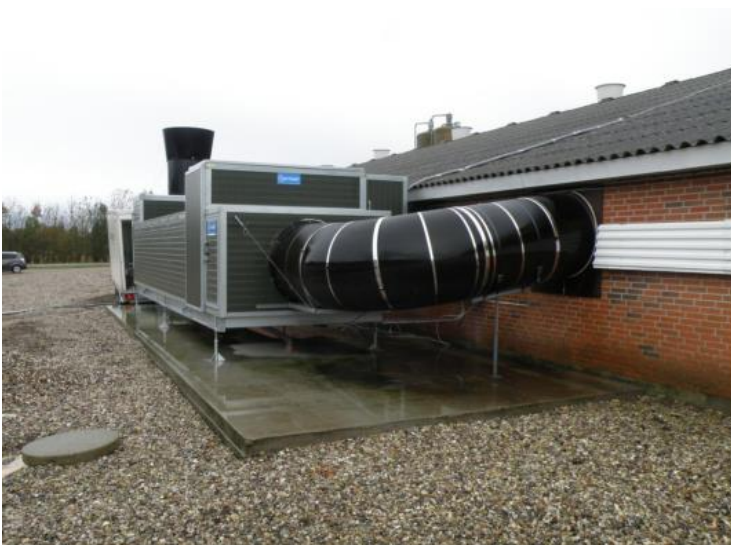
Varmeveksler opsat ved kyllingestald.
