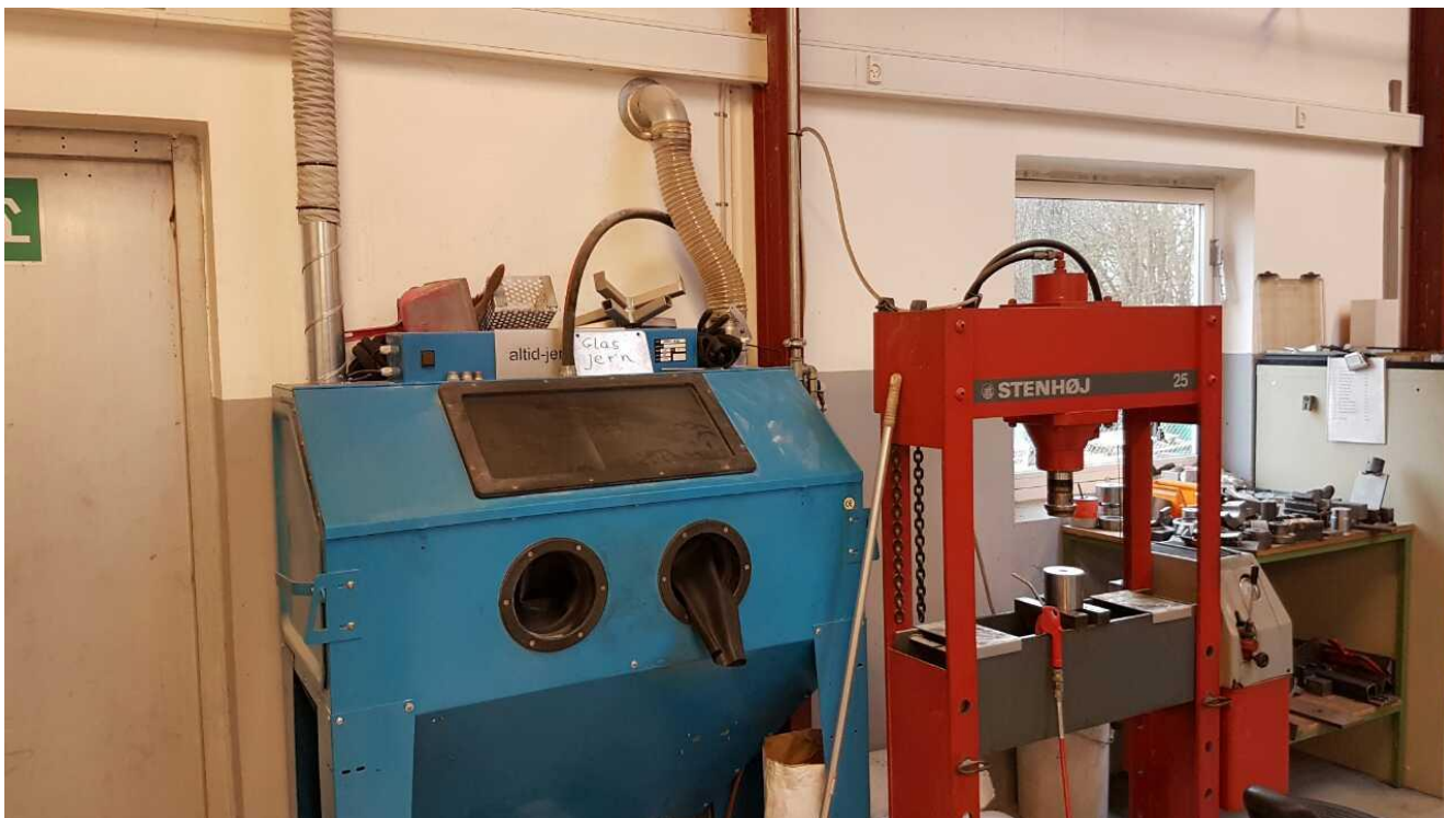
Glasblæser. Luftafkast er ført gennem vægen til skur med posefilteranlæg.
