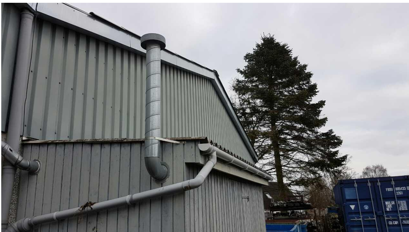
Luftafkast fra glasblæser efter rensning i posefilteranlæg.
