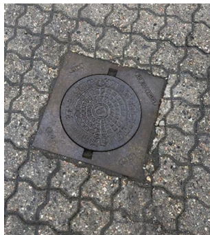
Figur 5 Påfyldningsdæksel nedsænket i terræn og dermed sikret mod påkørsel.
