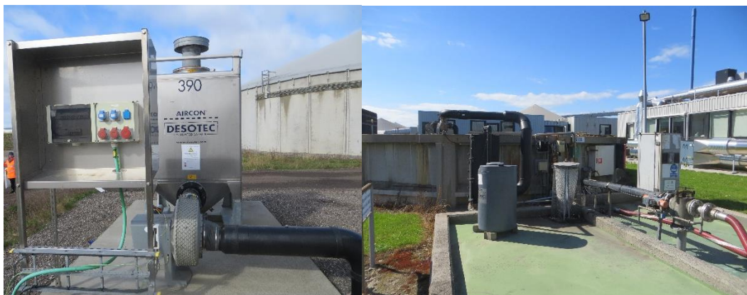
Tv: kulfilter 352, der renser afsuget fra 4 lagertanke, tank 31.10-31.13
