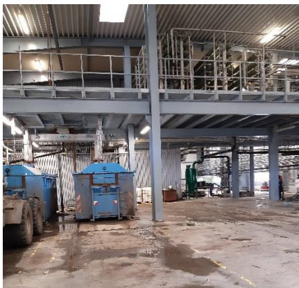
Dekanter til overskudsslam fra processen og opsamling af slam i containere placeret i bygning K.
