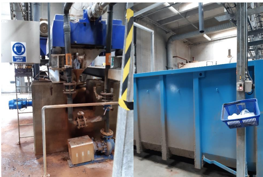
Dekanter og opsamling af slam i container i bygning R.
