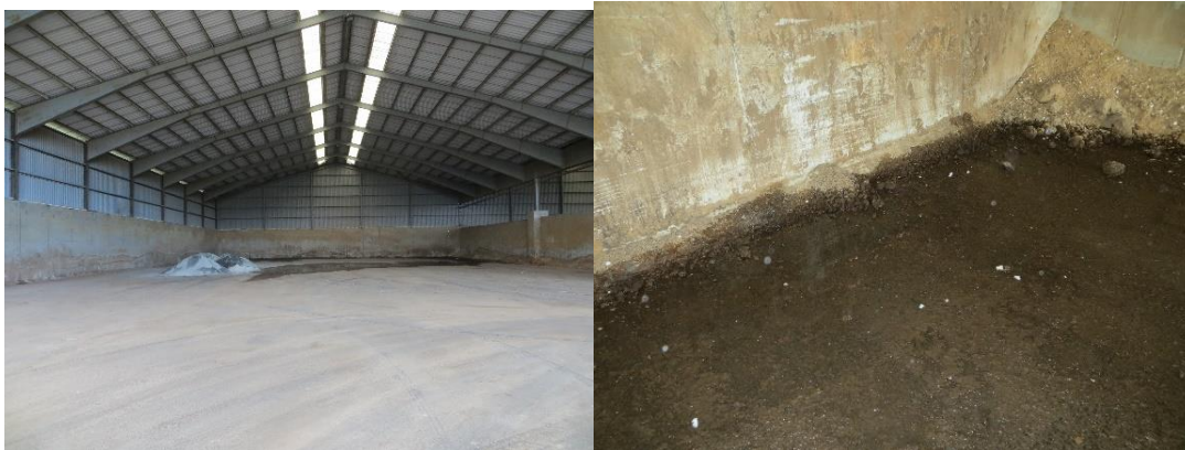
Tv: Tæt tag og faste vægge samt god belægning. Th: I et hjørne trængte vand ind ude fra
