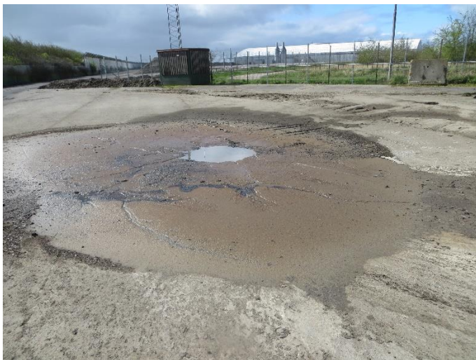
Større lunke/hul eller tilstoppet afløb med opstuvning af slam med oliefilm.
