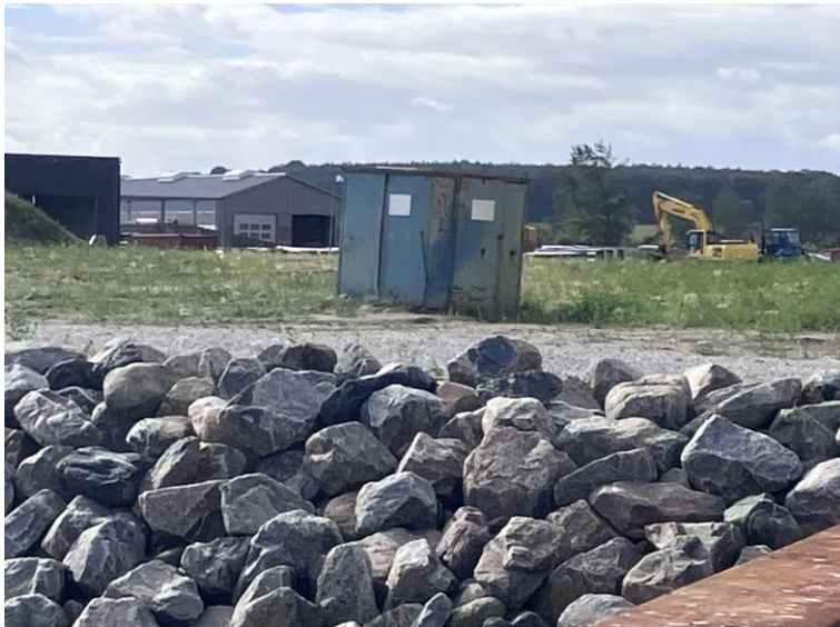
Figur 5 Skur på Etape 1 med grundvandsboring fra BG beton.
