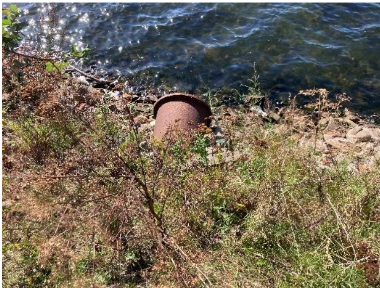
Figur 13. Nedgravet rør ført gennem dæmning på etape 1. Omtrentlige koordinater for udløbsrøret (med få meters usikkerhed) (WGS84): 55.85250 9.87640.
