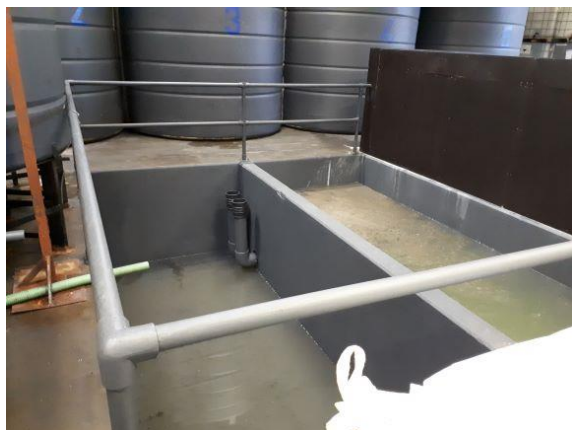
Udløbstanke (så sådan ud efter testkørsel).
