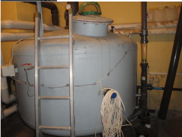
Et ældre sandfilter og 2 kulfiltre til filtrering af bassin vandet.
