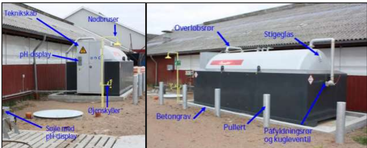
Figur 3. Opbygning og placering af syretank, betongrav, pullerter, påfyldningsrør, stieglas, overløbsrør, teknikskab, nødbruser etc.
