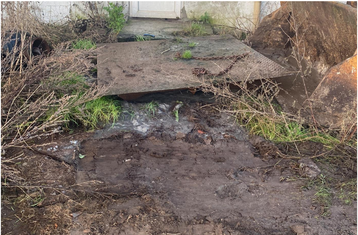
Tørbrønd er løbet over
