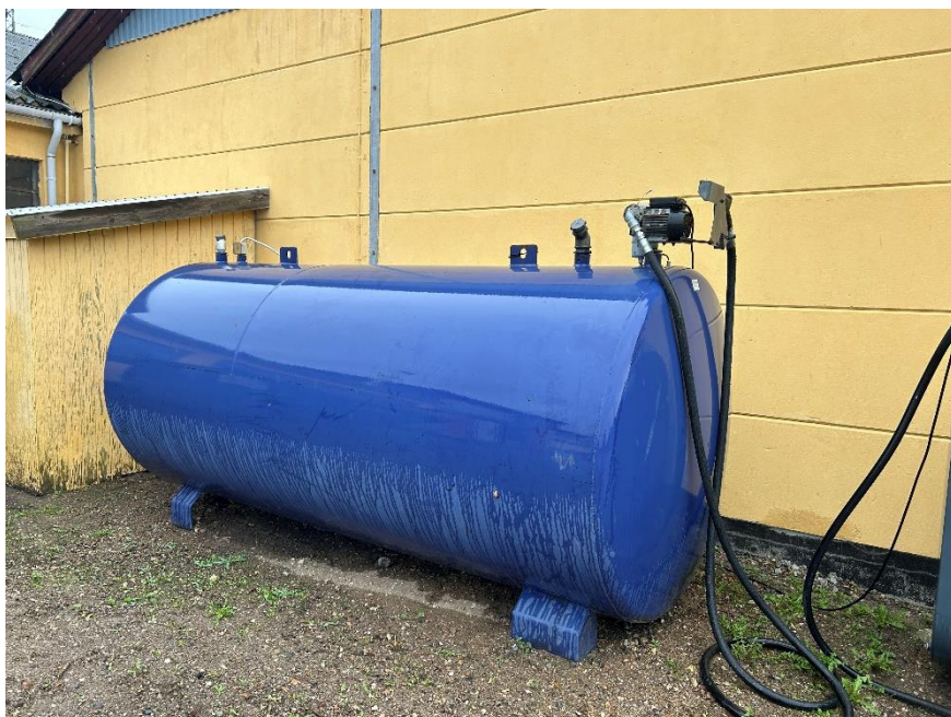
Fyringstank med pistol. I baggrunden det gamle kompressors skur. Ny kompressor er placeret indfor.
