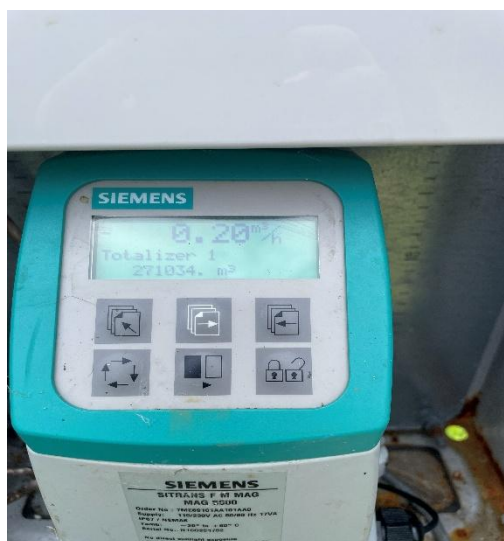
Foto 5: Pumpe 1 - kunne kun styres fra andet skab
