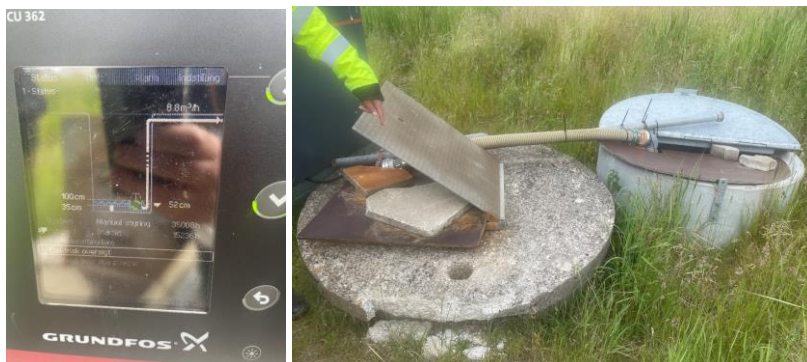
Pumpebrønd og styring af pumpe.
