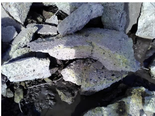
Opbrudt betondæk ved tank 5
