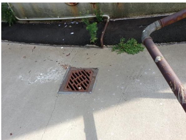
En af sivebrøndene ved T106
