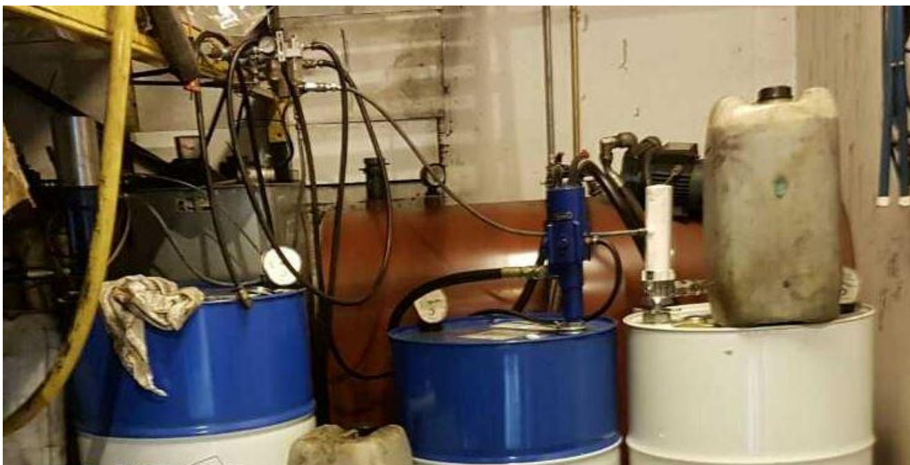
Fyringsolietank og spildolietank opstillet i olierummet.
