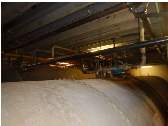
3. Rør til ind- og udpumpning og udluftning.
