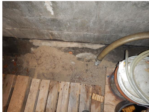
8. Hul i gulv i rum til farligt affald.
