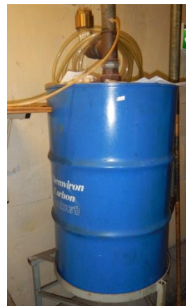
4. Kulfilter i kælder.
