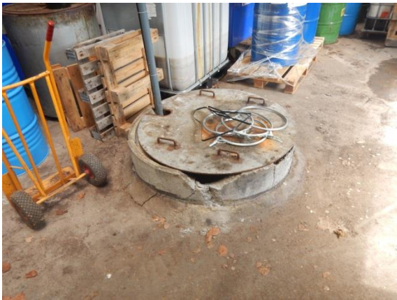
7. Brønd i rum til farligt affald med defekt kant.
