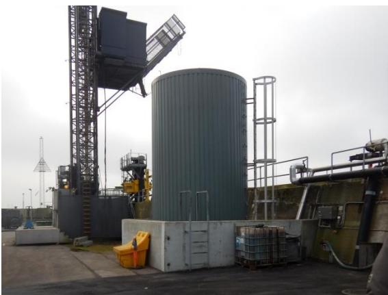
7. 40 m 3 tank ved færgeløje, hvor slopolie fra færgerne pumpes ind.
