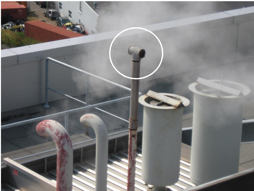
Foto 2, Damprør, udluftning fra fødevandstank til ovnlinie 5
