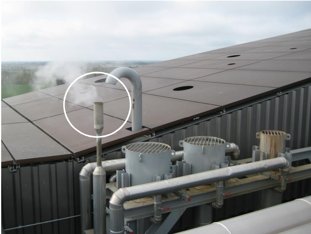
Foto 3, Dampudluftning på fødevandstank
