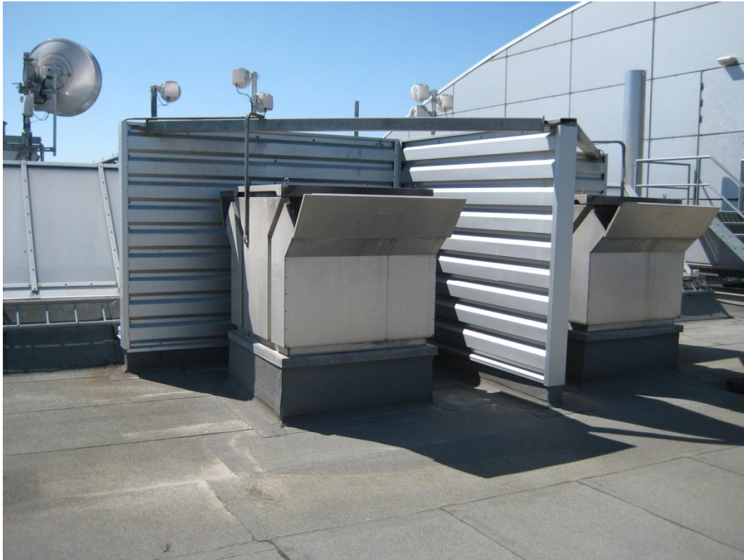
Foto 1, Afkast fra rumventilation på tag af røgrensningsbygning til ovnlinie 5
