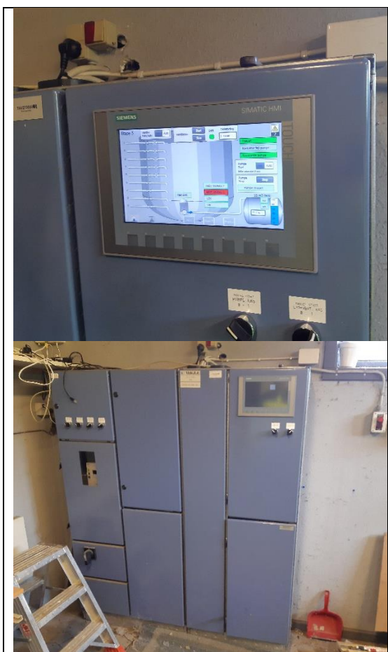
Figur 3. Virksomhedens SRO-anlæg placeret i maskinhallen
