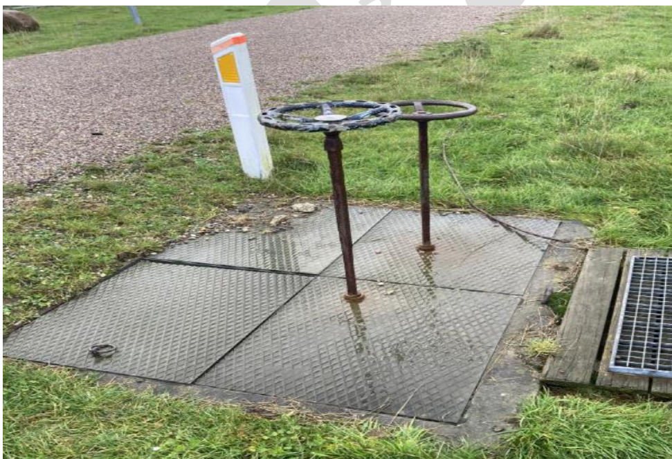
Figur 3. Ventiler til dræning af overfladevand fra tankgårde
