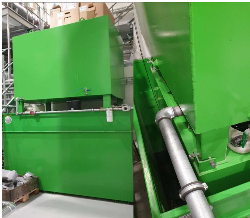
Figur 10. Tankene og rørføring i biogasbygningen
