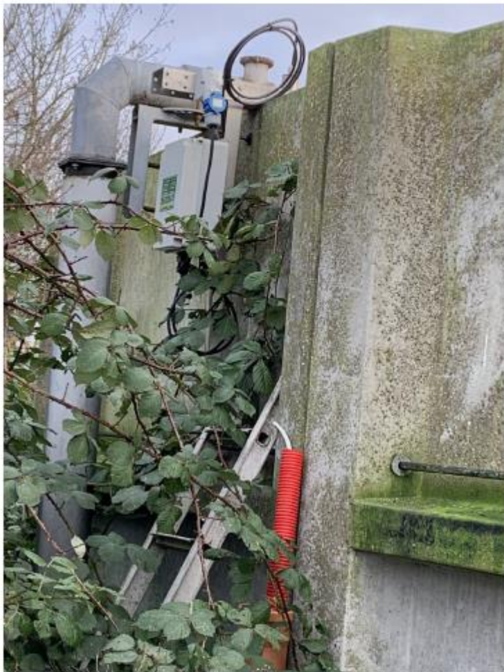
Alarmboks på gyllebeholder
