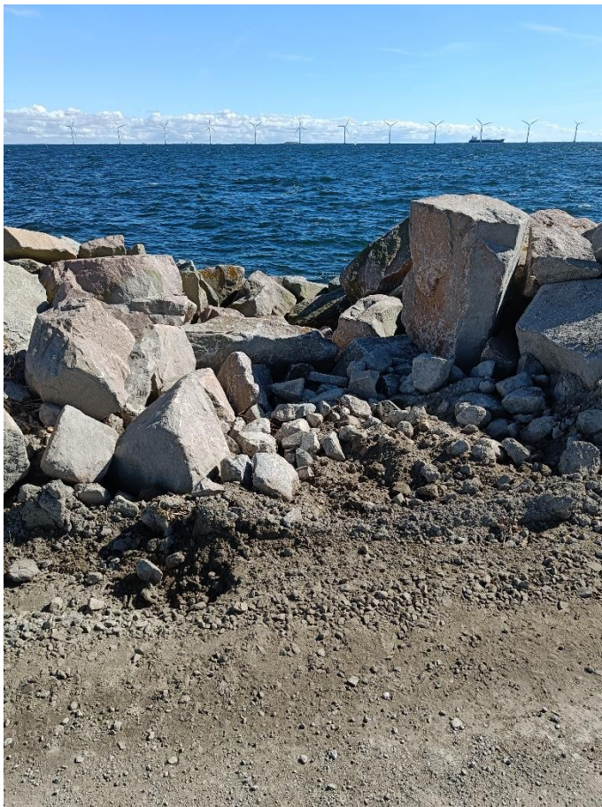
Billede 1.: Manglende kampesten i toppen af dæmningens østlige side.
