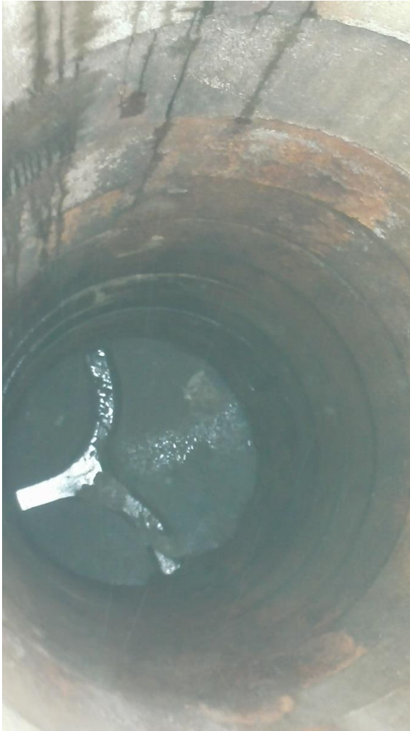
Foto 11. Perkolatbrønd PB4, på Etape 1.
