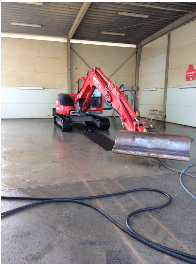
Vaskeplads med afløb til olieudskiller
