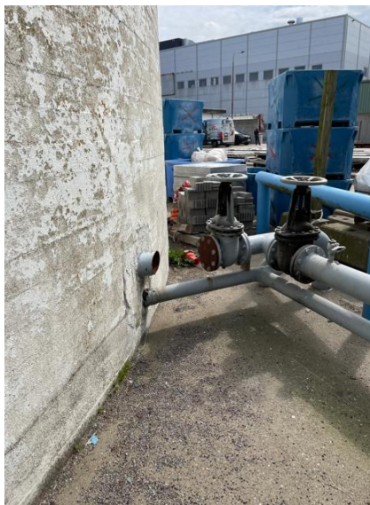
Tank 2, udenfor tankgård, afmonteret ventil
