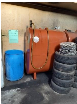
Billede 3 Oplag af spildolie og tegn på spild.
